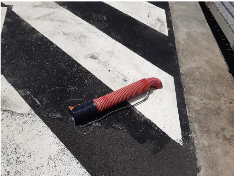
Arrivée électrique pour la potence
